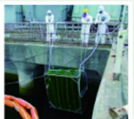
Fig.3 第一原発汚染水を除染
